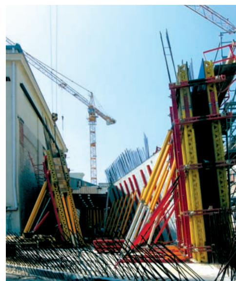
Nichts darf stürzen: Höchste Anforderungen an Ingenieur- und Baukunst auf der Baustelle des MHM im Juni 2006.
